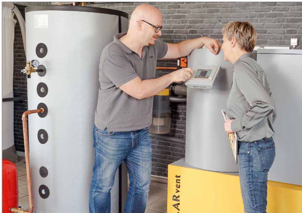
● Die Pelletheizung von Solarvent lässt sich mit einer Brauchwasser-Wärmepumpe und einer Solaranlage ergänzen ●
